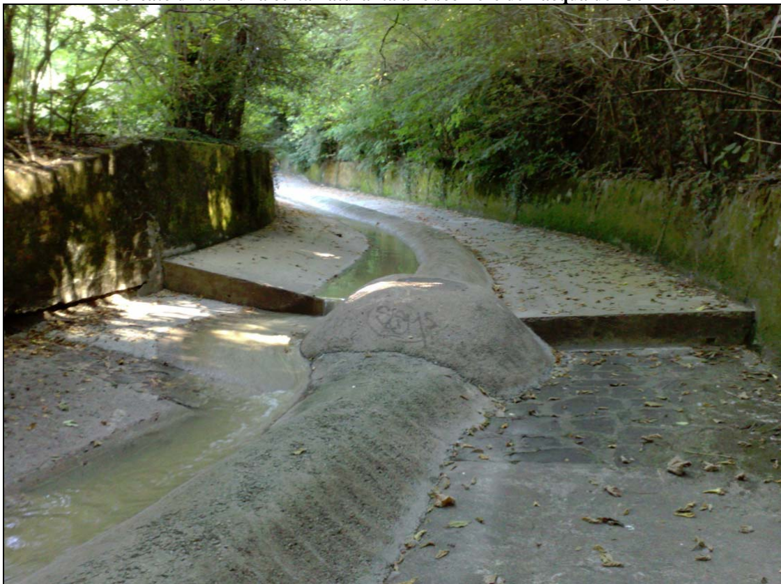
Figura 57: STATO DI FATTO dell’alveo e delle sponde cementificate.
