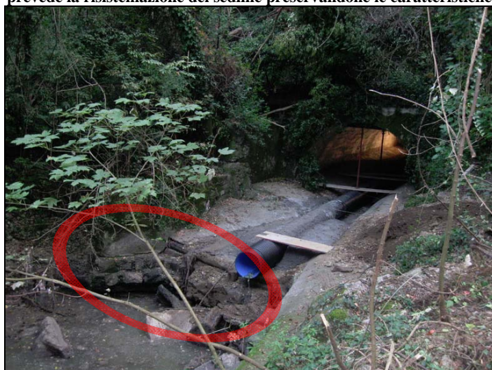
FOTO 16 - lavori della Protezione Civile Regionale anno 2009, tratto subito a valle di Viale Oriani. Al piede della nuova tubazione, in particolare lungo la sponda destra, si nota la presenza di un rivestimento del fondo in blocchi di pietra a testimonianza che prima della cementificazione superficiale dell'alveo, esisteva già un rivestimento del fondo in diversi tratti del torrente Corno.
