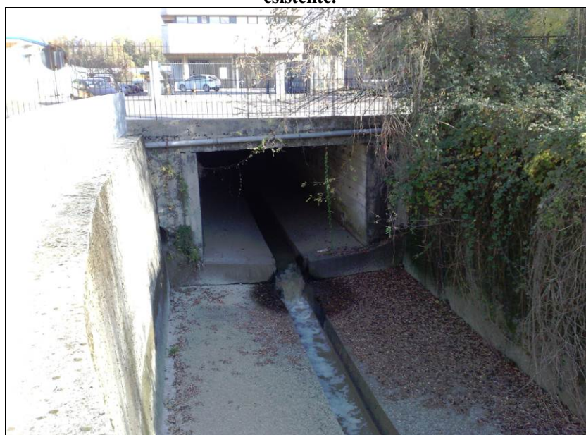
Figura 25: fuoriuscita del torrente Corno dall'area industriale. Il tratto è totalmente cementificato.
