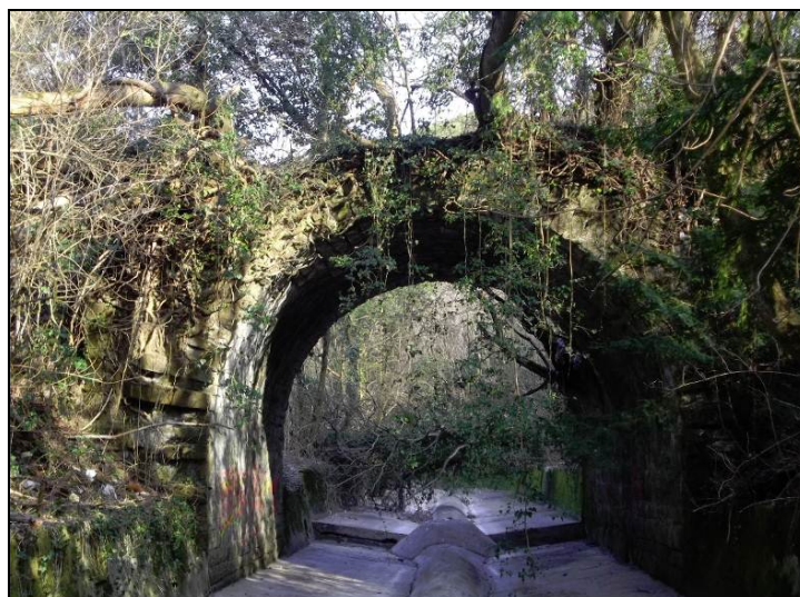
FOTO 12 - il vecchio ponte in pietra di via del Boschetto ripreso da valle.
