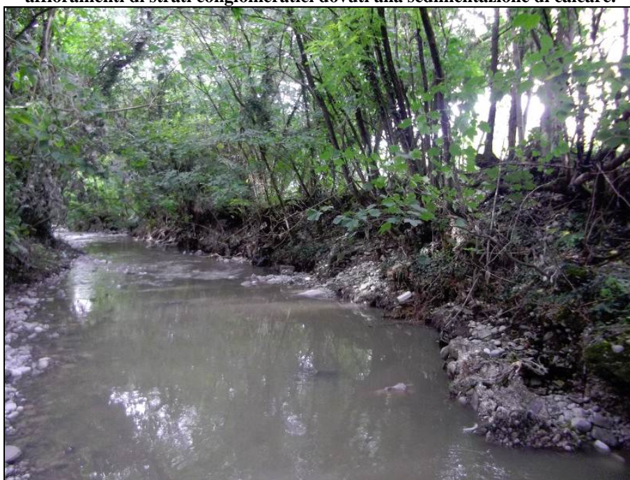
Figura 62: situazione dell'alveo e delle sponde a valle del guado. L'intervento prevede anche la manutenzione arborea e arbustiva presente pericolosamente lungo le sponde (piante scalzate, inclinate). Si notino in destra gli affioramenti conglomeratici naturali.
