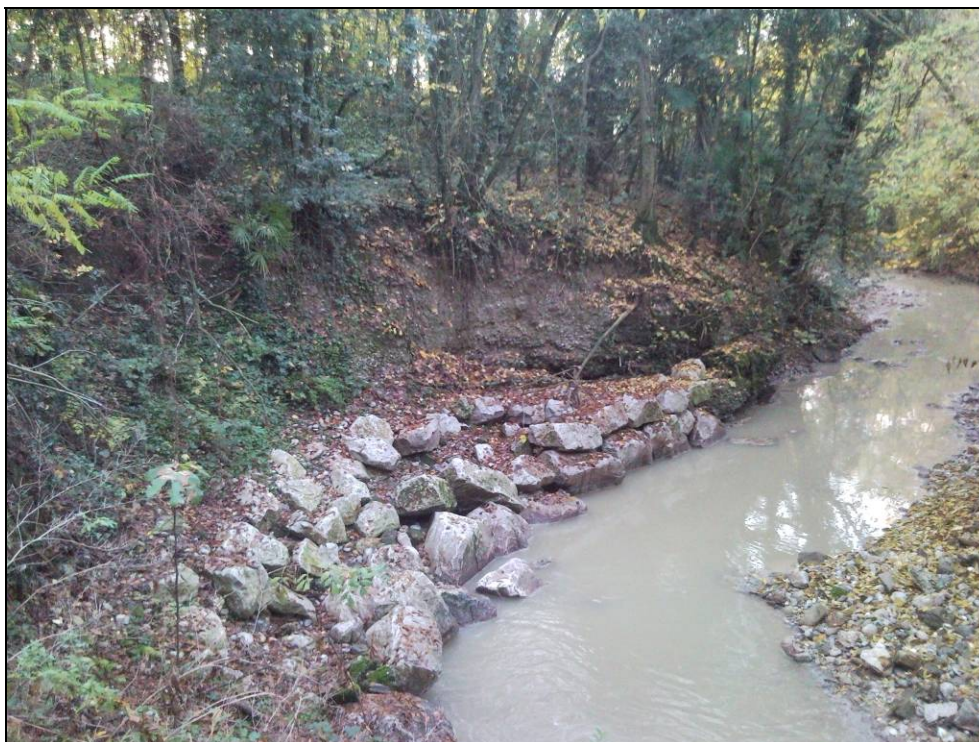
Figura 42: visibili cedimenti lungo la sponda sinistra a valle del terrapieno di Viale Oriani.
