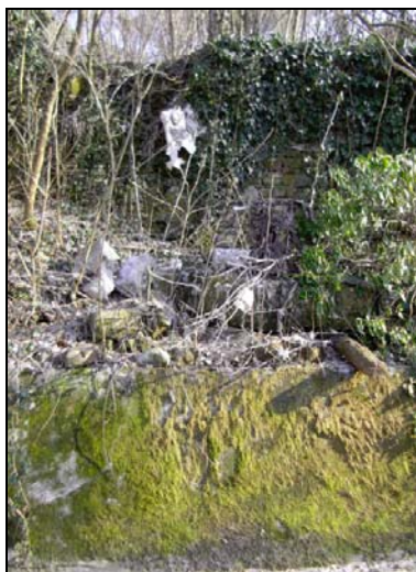
FOTO 8 - sponda del torrente Corno e muro di sostegno in pietra locale faccia a vista
