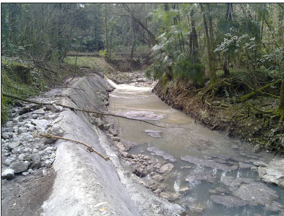
Figura 41: il torrente Corno a valle del terrapieno di Viale Oriani. In sponda sinistra si nota l'intervento, realizzato dalla Protezione Civile nel 2010, che raccoglie le acque fognarie all'interno di una tubazione e le rilascia, come si vede dalla foto, poco più a valle del terrapieno di viale Oriani.
