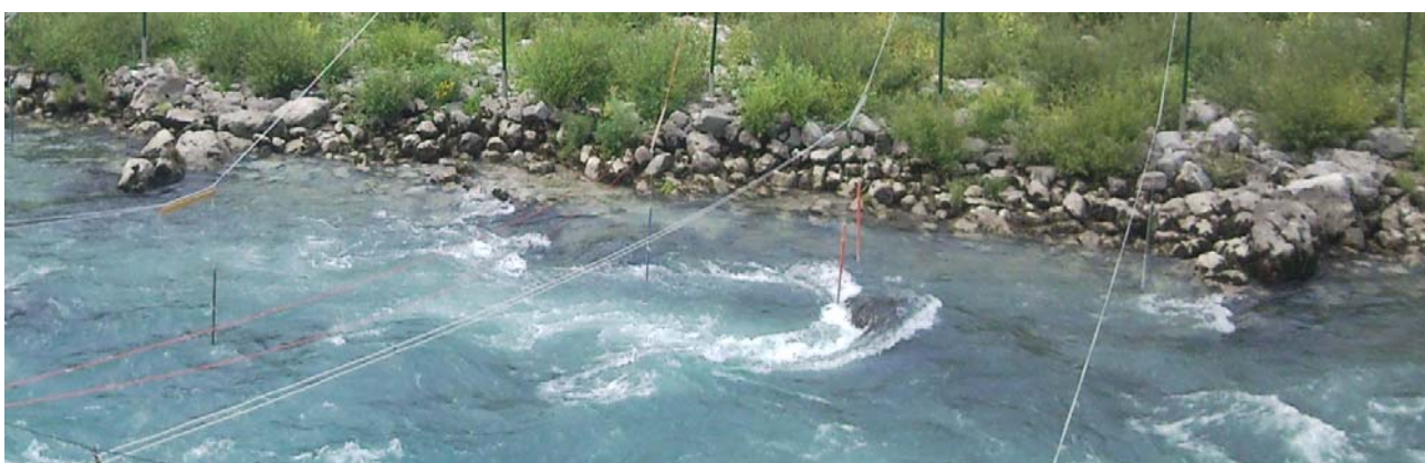
Figura 66: sistemazione spondale in sassi e pietre lungo il fiume Isonzo a Salcano.
