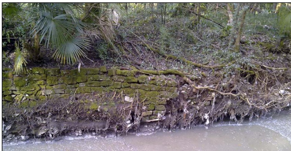
Figura 6: vecchie protezioni spondali in pietra, presenti all'interno del parco lungo il Corno, a valle del terrapieno di viale Oriani.
