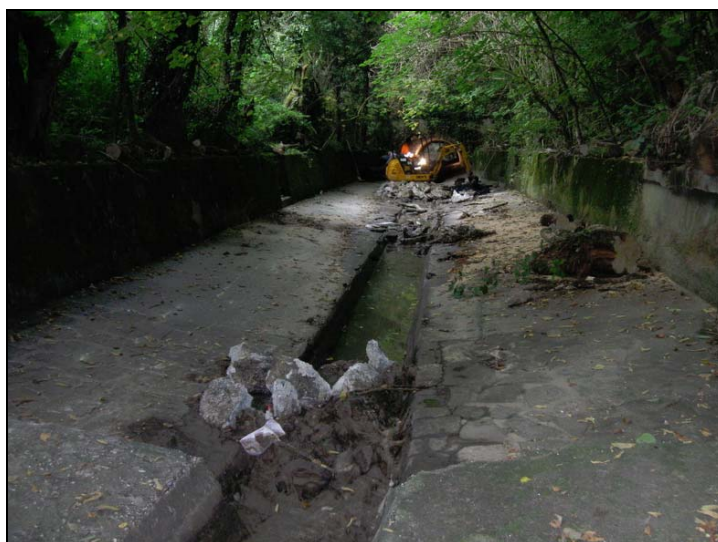
FOTO 9 - lavori della Protezione Civile Regionale nell'anno 2009. Tali lavori hanno evidenziato l'esistenza in diversi tratti di una vecchia protezione del fondo in pietra.
